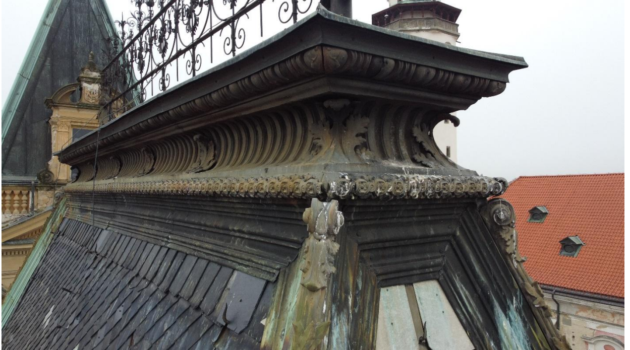
Pohled na členění oplechování a zanesení nečistotami
