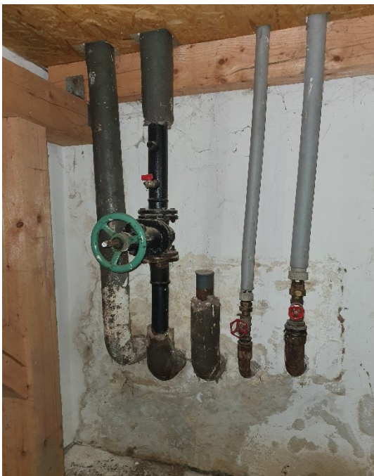
Foto 15 - vstup potrubí do objektu Kosmonautů 163
