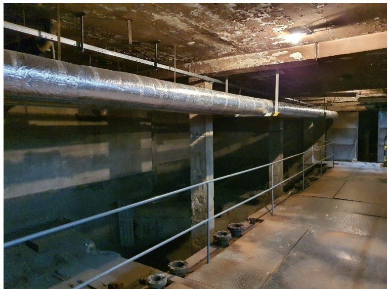
Foto 8 - vnitřní vedení přívodního potrubí prostory bývalé uhelné kotelny
