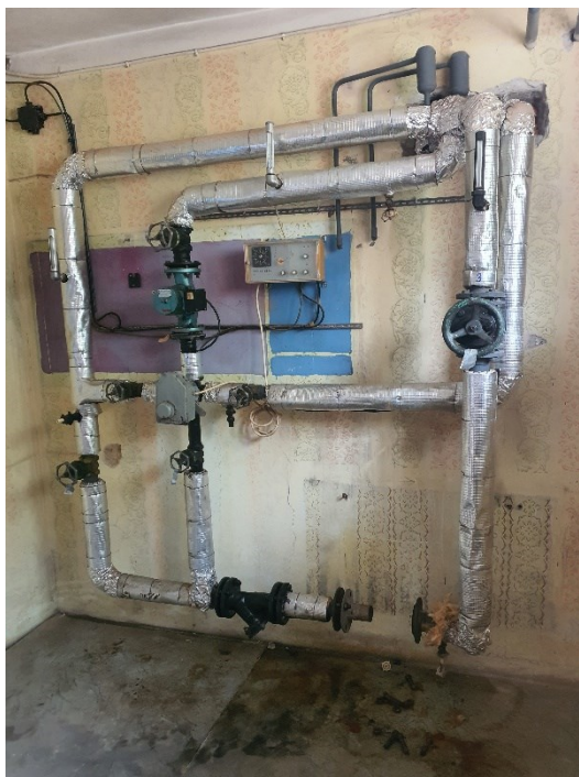
Foto 16 – směšovací stanice objektu Kosmonautů 163
