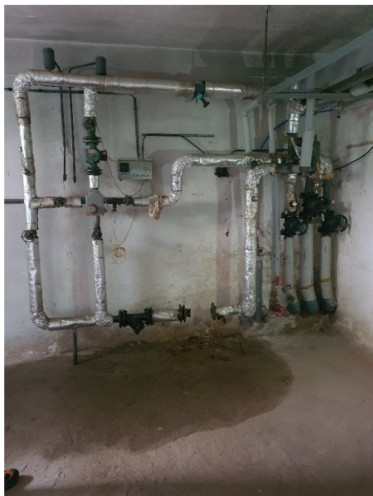
Foto 17 - vstup potrubí do objektu Kosmonautů 159
