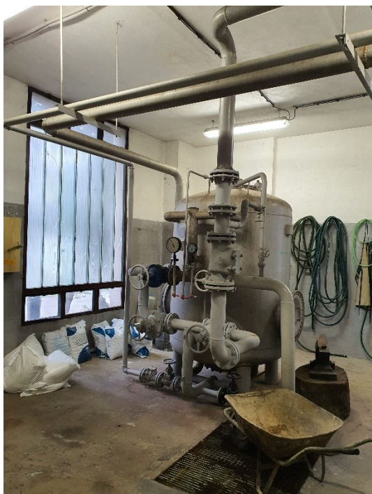
Foto 6 - dnes nepoužívaná úpravna studené vody pro ohřev teplé vody
