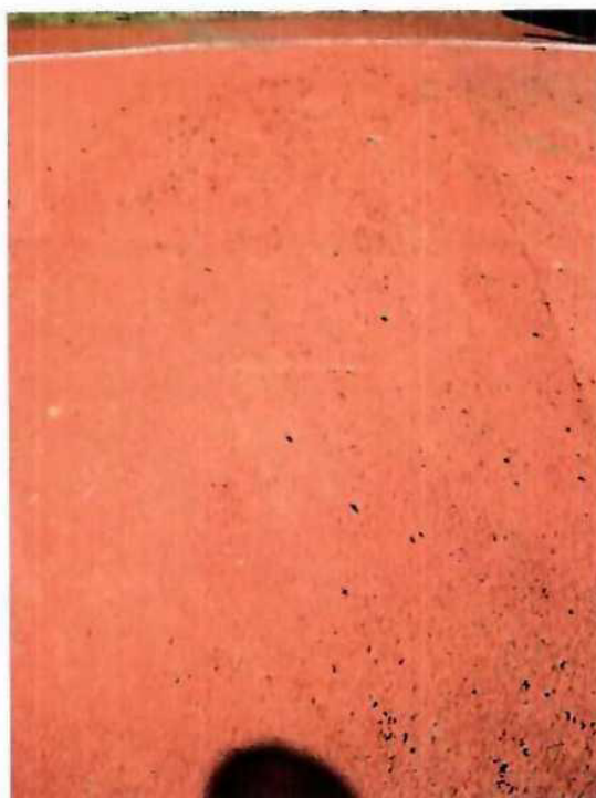
Silně poškozená odhodová část
