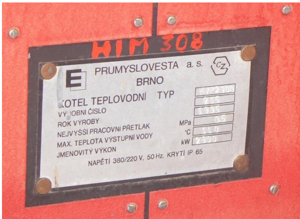
Obrázek 3 - štítek jednoho z kotlů s výrobním číslem 215
