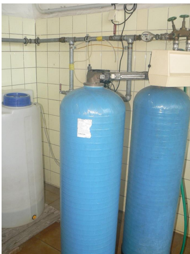
Obrázek 13 - úpravna vody technologické vody
