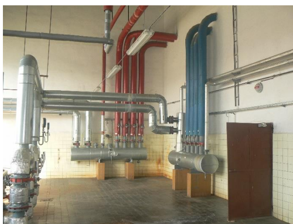
Obrázek 9 - rozdělovač a sběrač v místnosti strojovny
