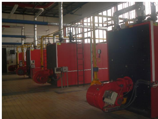
Obrázek 2 - prostor s čtveřicí plynových nízkotlakých kotlů 4x 2900kW
