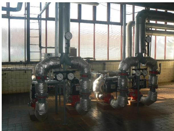
Obrázek 10 - dvojice oběhových čerpadel pro každou topnou větev do sídliště
